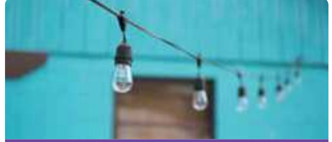
مصابيح كهربائية لا تعمل
