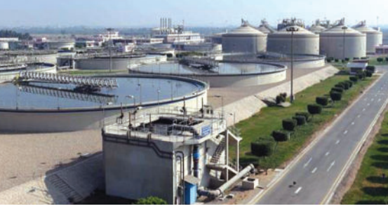
محطة الجبل الأصفر لمعالجة مياه الصرف - القليوبية
