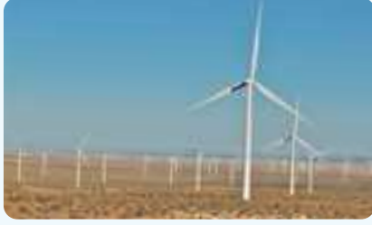
محطة جبل الزيت
